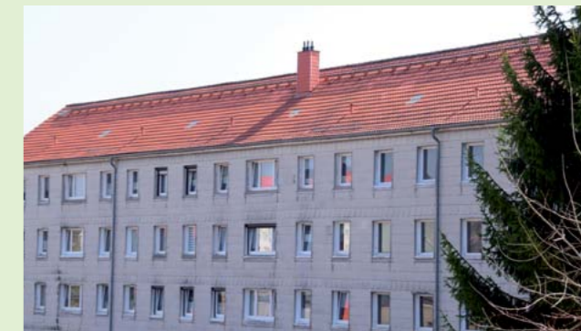
In der Straße der Einheit 45–49 wird in diesem Jahr der Dachstuhl saniert und das Dach neu eingedeckt.
