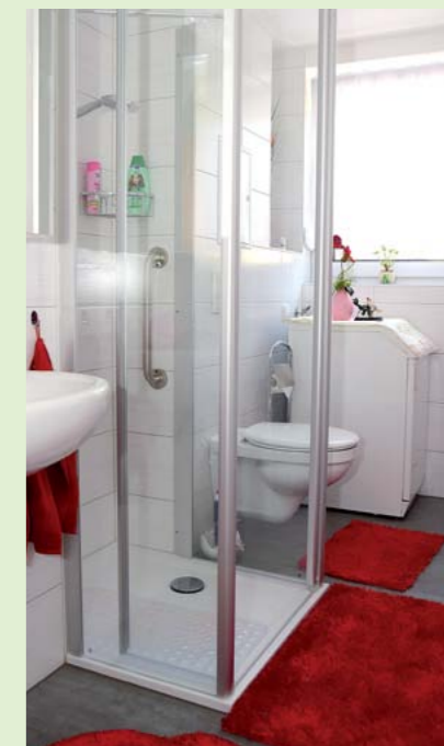
In der ersten Etage besitzen die neuen Duschen eine geringe Einstiegshöhe.
